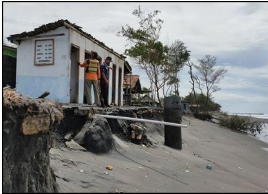
Gambar 4. Kondisi Kamar Mandi Pantai Glagah
